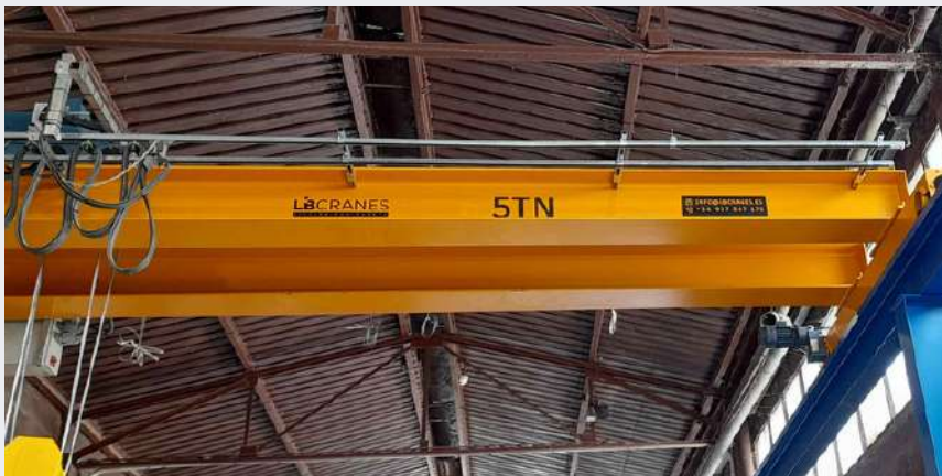
Puente grúa birraíl de 5Tn
