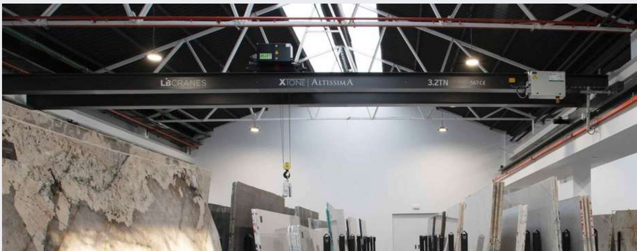
Puente grúa birraíl de 3.2Tn
