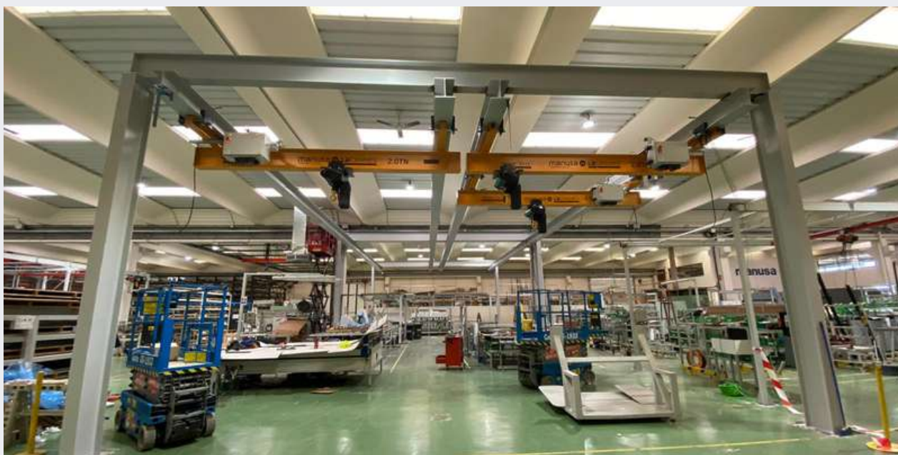
Puente grúa suspendido de 2Tn
