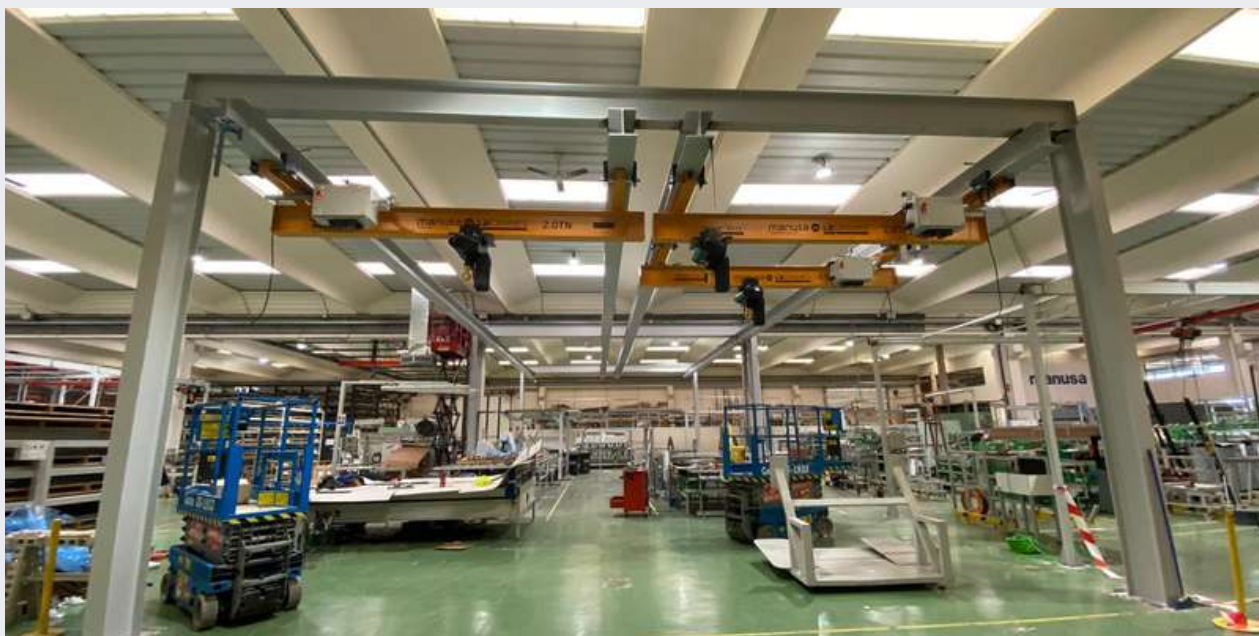
Pont roulant suspendu de 2 tonnes
