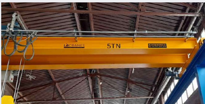
Pont roulant bipoutre de 5 tonnes.
