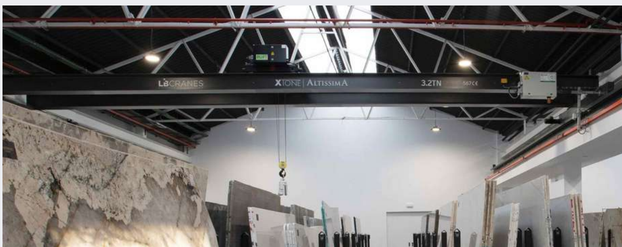
Pont roulant bipoutre de 3,2 tonnes
